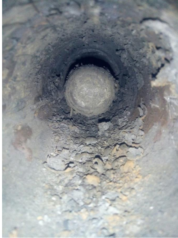
Figura 14. Incrostazioni dal tubo in uscita dal filtro primario
